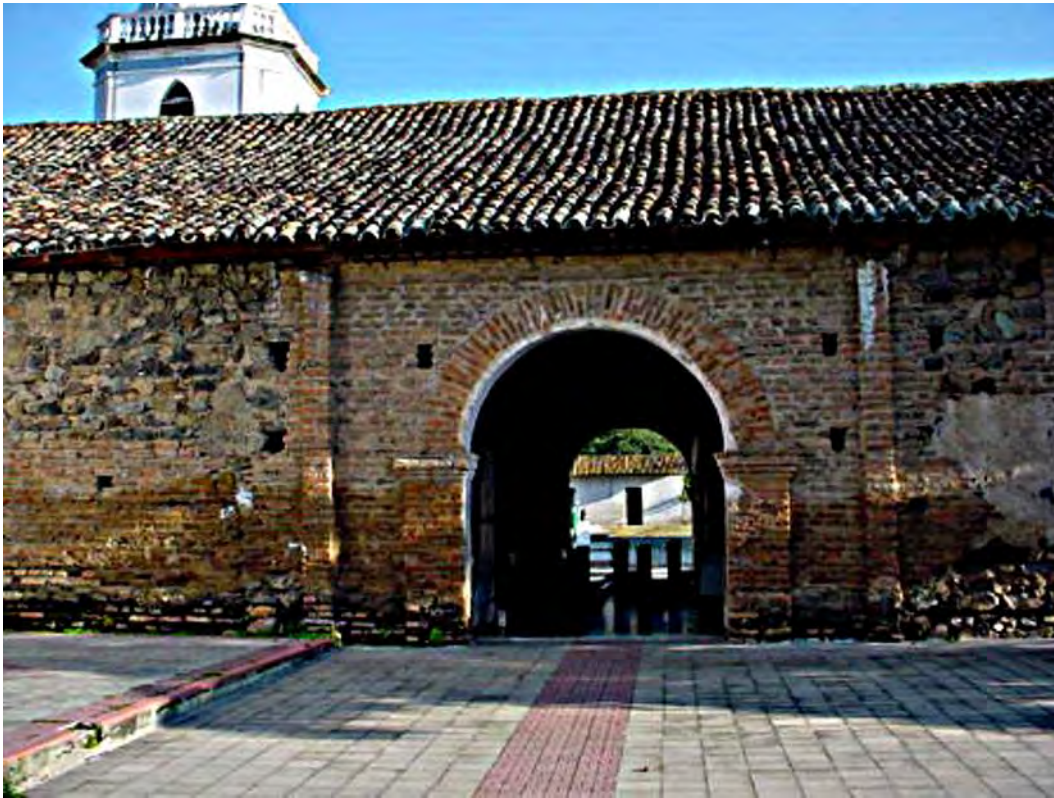
Iglesia de Ciudad Antigua, Nueva Segovia, Nicaragua (1611-1709). Uso de ladrillos de barro cocido. Nótese el arco de medio punto.
