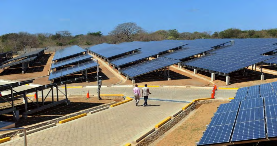
La planta se compone de 5580 paneles solares
