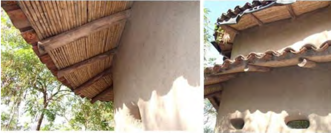
Figura 3: La casa de bahareques estudiada en Matagalpa, Nicaragua, con un amplio voladizo de techo, fotografías del autor.
