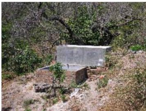
Figura N° 9. Obraje no techado de 2 pilas, Grupo Los Nonualcos, San Rafael Obrajuelo, La Paz.
